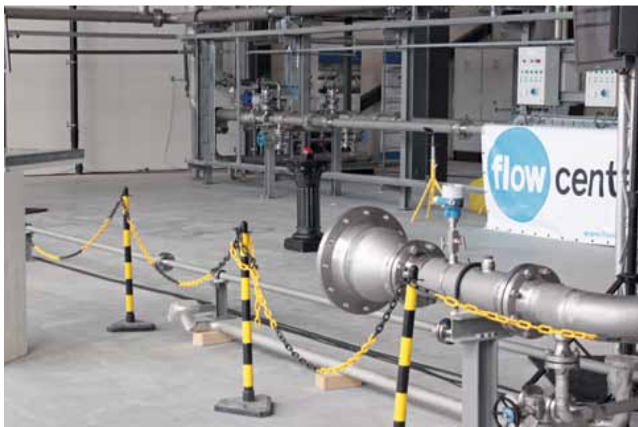
Als eerste is in de Duurzaamheidsfabriek de installatie XCaliber voor flowmeting opgebouwd.
