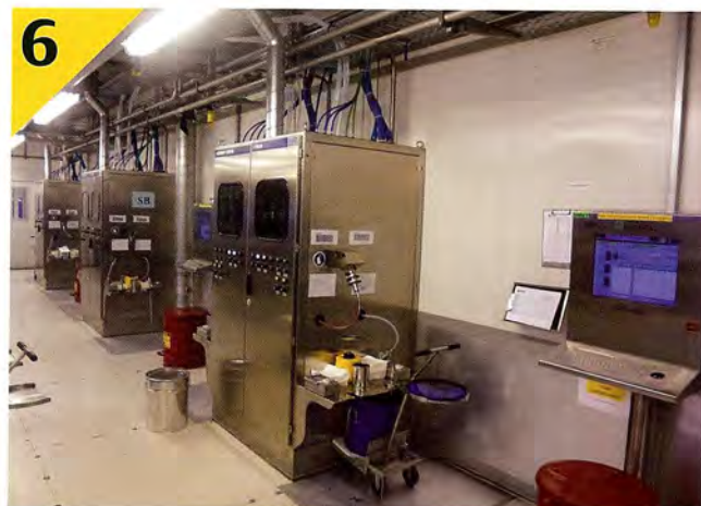
6. De minder gevraagde kleuren komen uit blikken, die worden aangesloten op deze doseerkasten. Door de leidingen bovenaan gaat de lak naar de spuitrobots. Op de beeldschermen is te zien wanneer welke lak nodig is.
